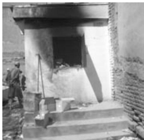
Incinérateur de l'hôpital de Maïwand
