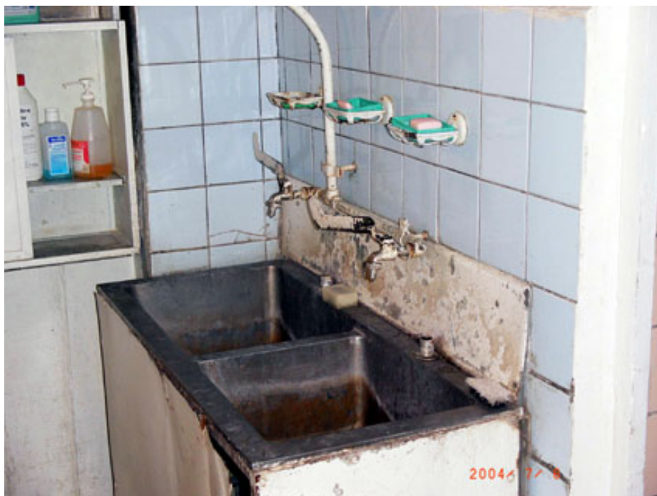
Photo 5 : coin de lavage des mains, servant aussi pour le lavage des instruments de la chirurgie en post-opératoire.
